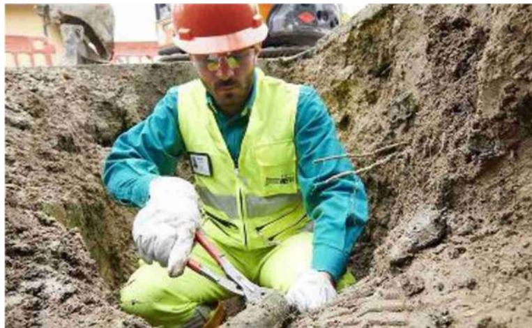
In questa foto d'archivio un intervento di manutenzione sulle tubature da parte di Hera
