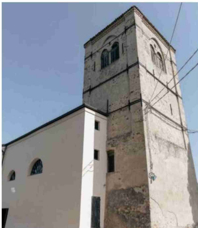
La Torre campanaria di Oliveto che necessita lavori di restauro
