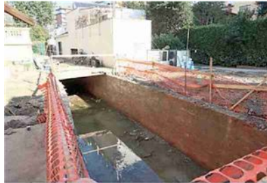
I canali dopo l'alluvione
