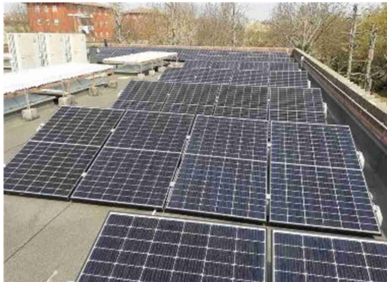
I pannelli fotovoltaici installati sugli uffici postali di Castel Maggiore e Molinella
