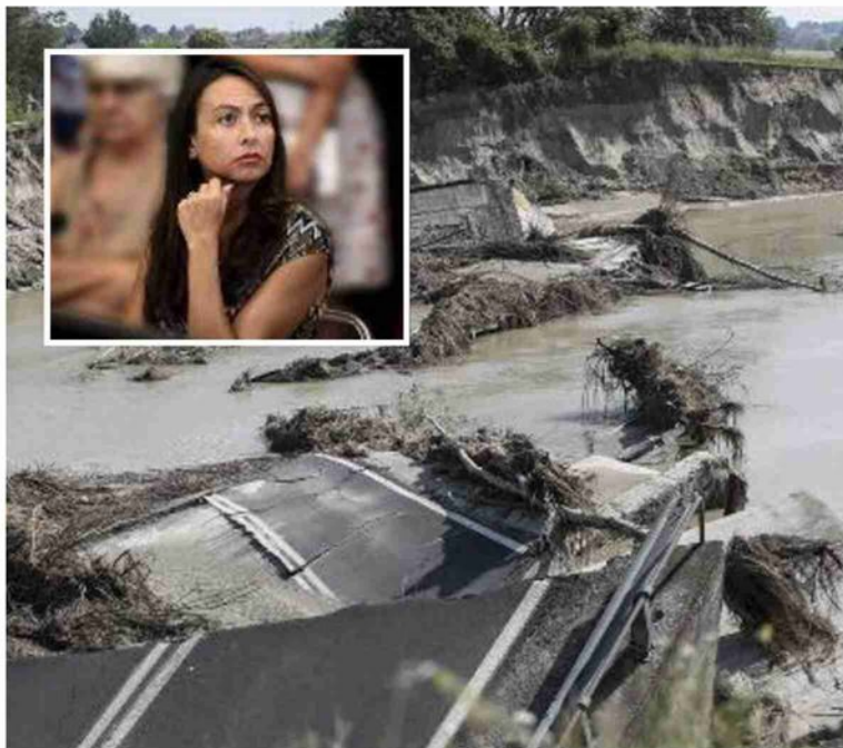
Il ponte della Motta all'indomani dell'alluvione di maggio: la ricostruzione prosegue Nel riquadro, la vicepresidente della Regione Emilia-Romagna, Irene Priolo
