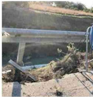
La frana in via Bosco a Berra che ormai persiste da anni
