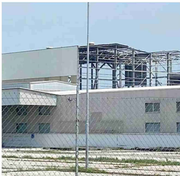
L'ex Cercom, che occupa un'area di venti ettari di fronte al canale navigabile, nei pressi del depuratore lagunare, dopo anni di abbandono e di incuria, è attualmente oggetto di lavori di rimozione di lamiera e di infissi ammalorati
