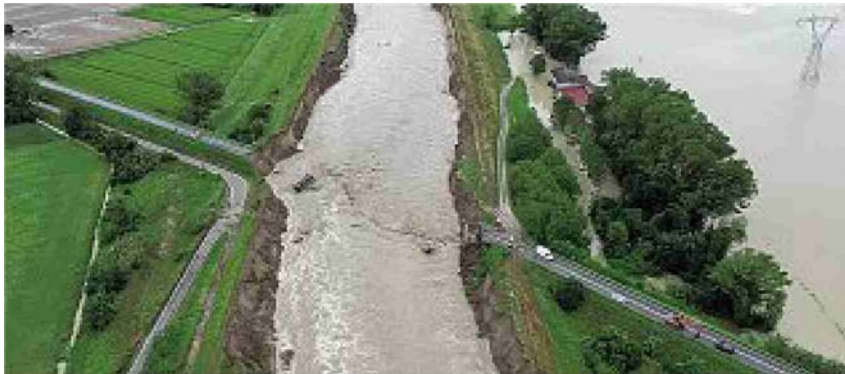
Disastro A Molinella ieri mattina è crollato il ponte della Motta, che era stato chiuso la sera precedente (immagine è dei Vigili del fuoco)
